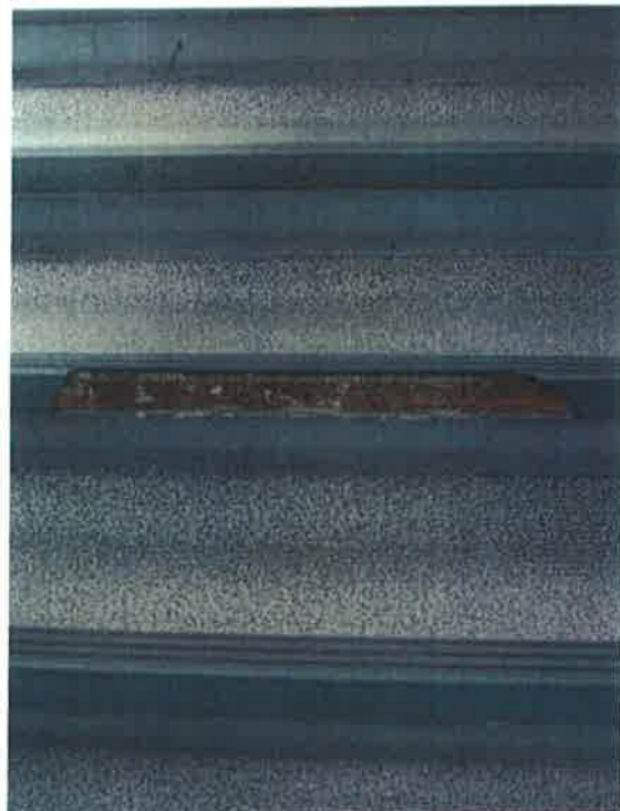
1.185/mezi 1. → 2. NP → poškozená hrana
