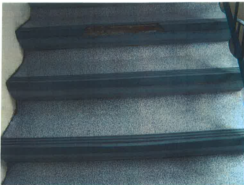
1184/mezi 2. – 3. NP – poškozené hrany schodišťových stupňů
